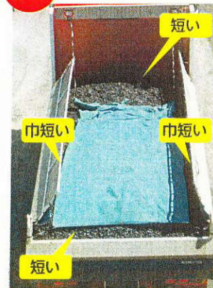
要改善 中シートの大きさ不足、メッシュシート禁止
