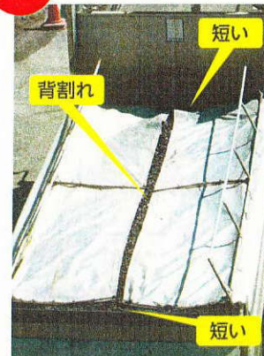
要改善 背割れ、長さ不足
